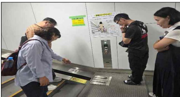
역사 출입구 경사로 내 자전거 전용 자동 이송 컨베이어 설비
